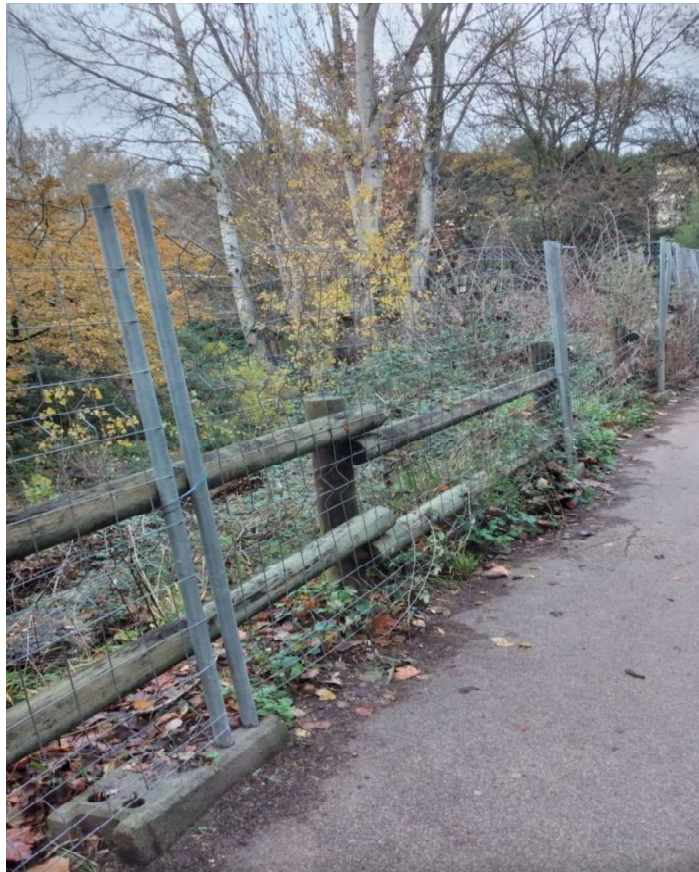
Effondrement des berges de 2019 et emplacement réservé ER 233
